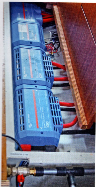
Über einen Zwischenboden wurde zusätzlicher Platz für die Technik geschaffen.
