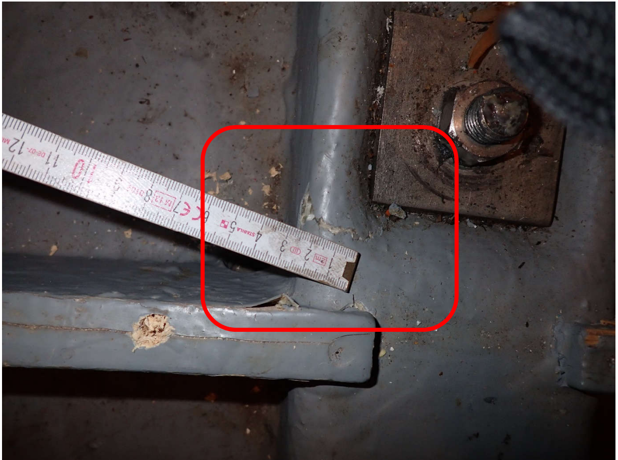
Rissbildung im Laminat, exemplarisch, am Mastfundament
