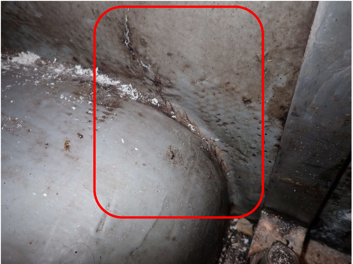
Rissbildung im Laminat, exemplarisch, am Mastfundament
