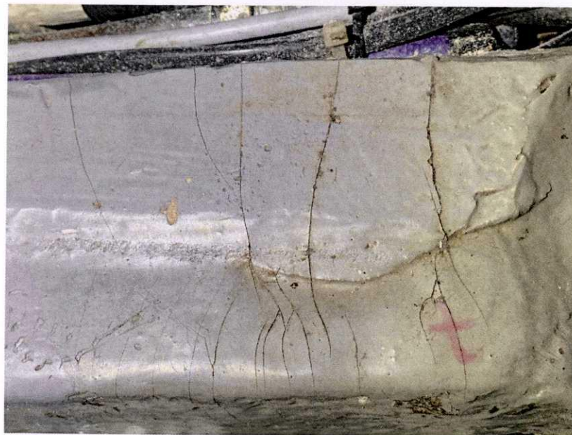
Rissbildungen an der Bodenwrange
