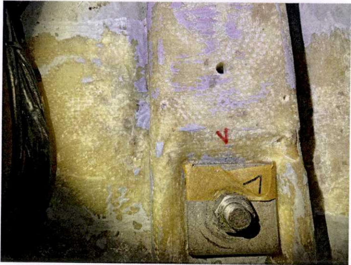
Weißbruch an dem Mastfundament
