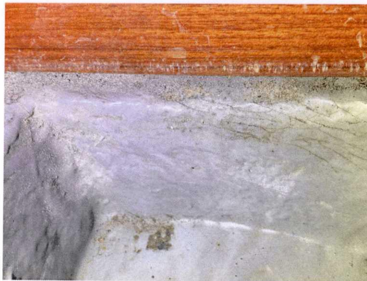
Weitere Rissbildungen an den Bodenwrangen
